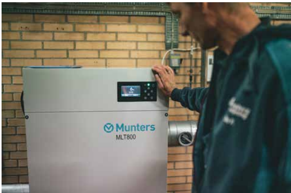
Ole Frederiksen, Vordingborg Forsyning, ved den nye MLT800-affugters AirC betjeningspanel
