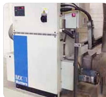
Před upgradem Odvlhčovač Munters MXT2800 vybavený původním ventilátorem
