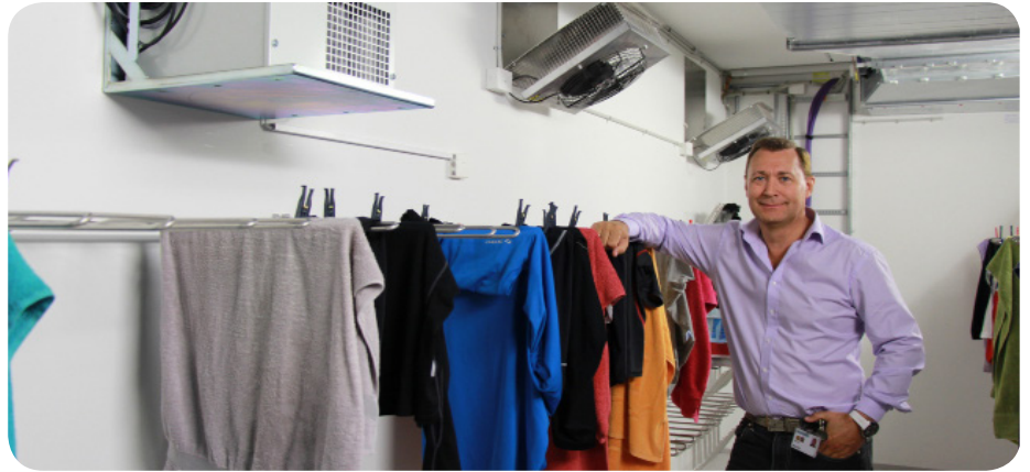
Michael Götz, Projektledare Siemens A/S, i det nya torkrummet
