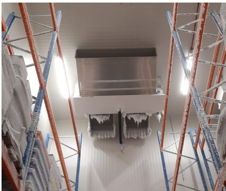
L'humidité et la glace menacent l'environnement de travail dans la chambre froide.
