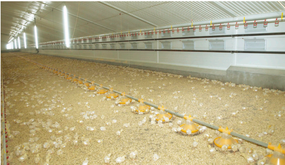
Flere IW-luftindtag monteret i en fjerkræstald.
