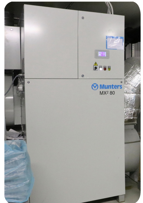
Déshumidificateur MX 2 80 de Munters avec pré- et post-refroidisseur permettant de conditionner l'air.
