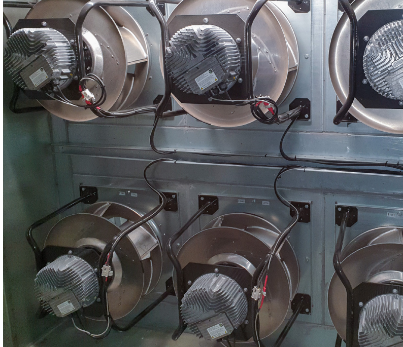
Después: Ventiladores EC en montaje de pared
