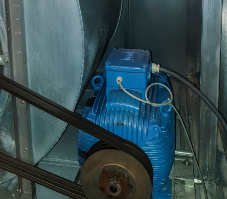
Vorher: Riemengetriebener Lüfter
