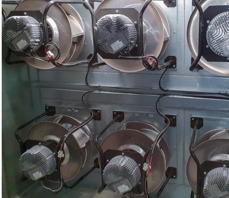
Nachher: EC-Ventilatoren in einer Ventilatorwand-Konfiguration
