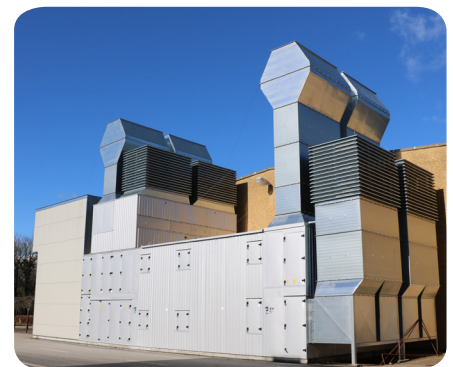
Eine der beiden größten Anlagen auf 126.000 m 3 /h hat 6 kleinere Anlagen ersetzt und große Einsparungen gesichert.
