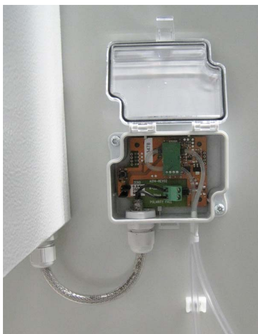
Figuur 3.23 Aansluiting DPT (procesluchtventilator)
