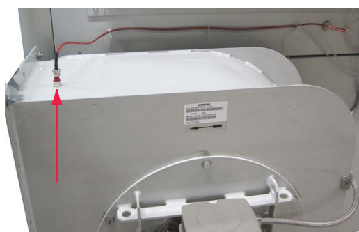
Figuur 3.21 PT1000-aansluiting bij regeneratieventilator
