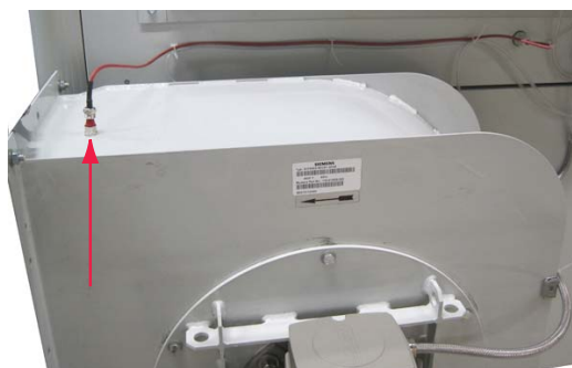
Figur 3.21 PT1000-tilslutning ved regenereringsventilator
