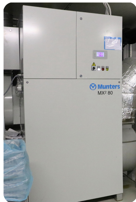
Munters sorptionsavfuktare MX 2 80 med för- och efterkyla för att konditionera luften.
