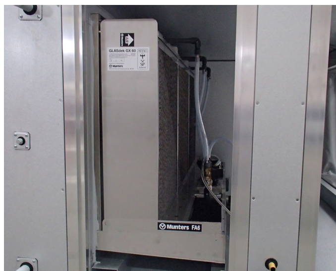
Przykład instalacji FA6 w sekcji centrali wentylacyjnej
