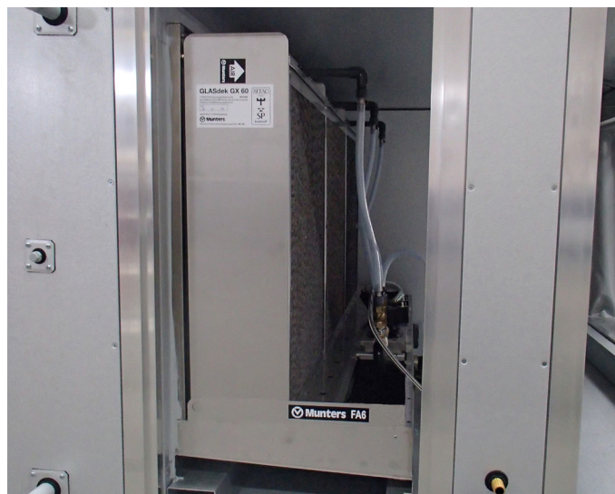
Eksempel på en FA6-installation i en sektion af et ventilationsaggregat
